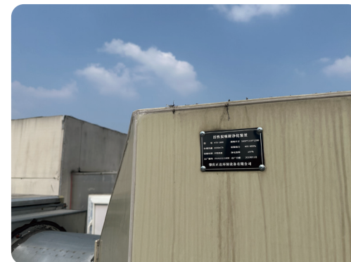
活性炭过滤装置
